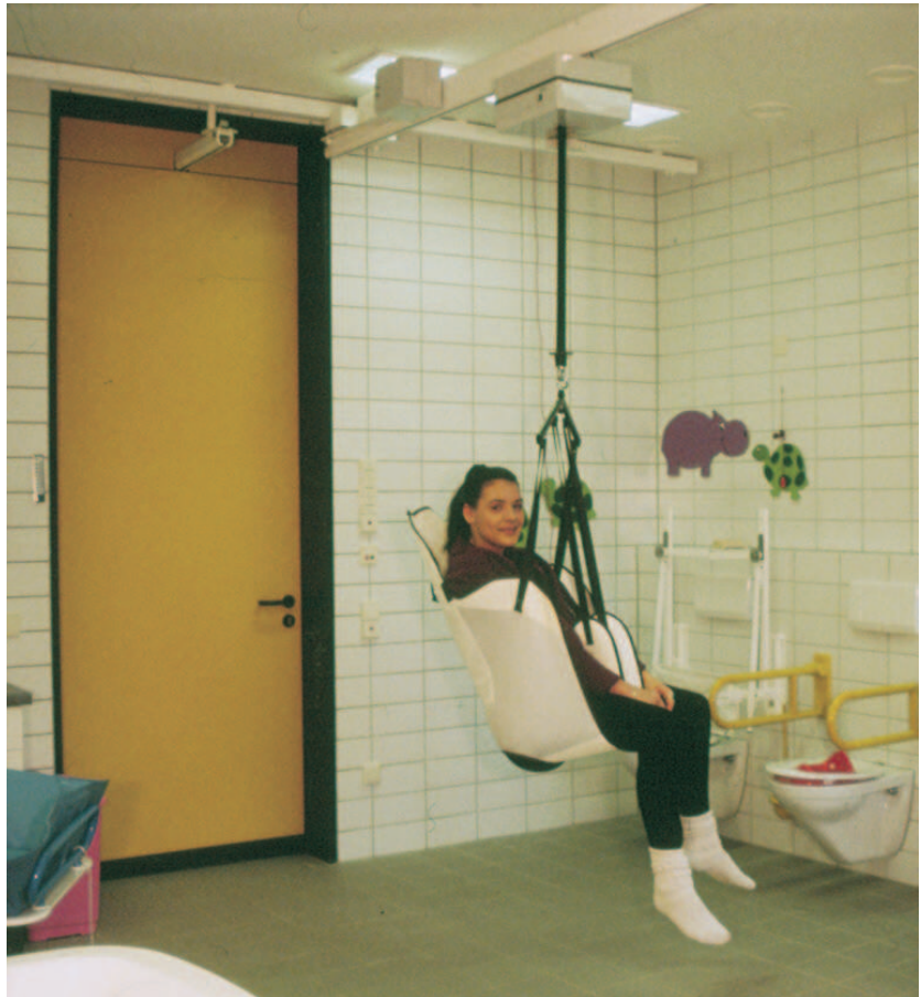
Eine Traversenanlage ("H"-förmige Anordnung der Schienen) macht es möglich, jeden Punkt im Raum zu erreichen (Foto oben und unten links).
